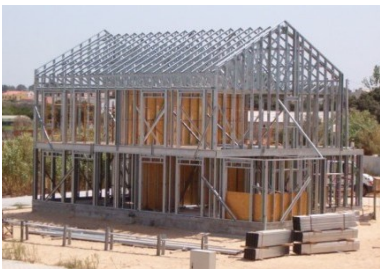
Estrutura metálica em residência: não recomendável
