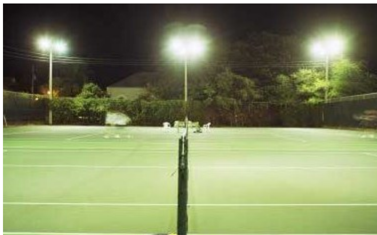
Lâmpadas de vapor metálico - quadra esportiva (nota-se um bom IRC)
