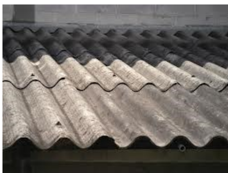
Telhas de amianto
