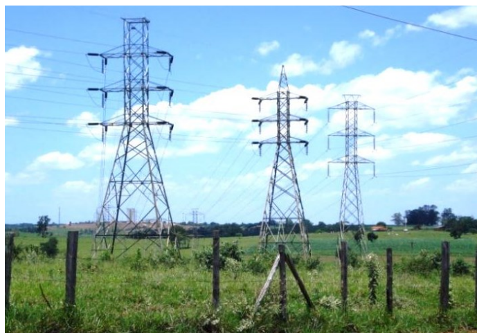
Torres de alta tensão - zona rural de Campinas/SP
