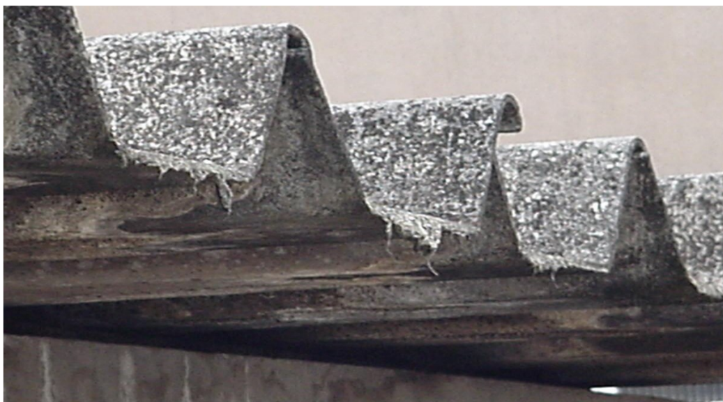
Telha de cimento amianto, onde podemos notar seu desgaste em função de sua textura porosa e deduzir que esta telha já está soltando a fibra mortal do amianto.
